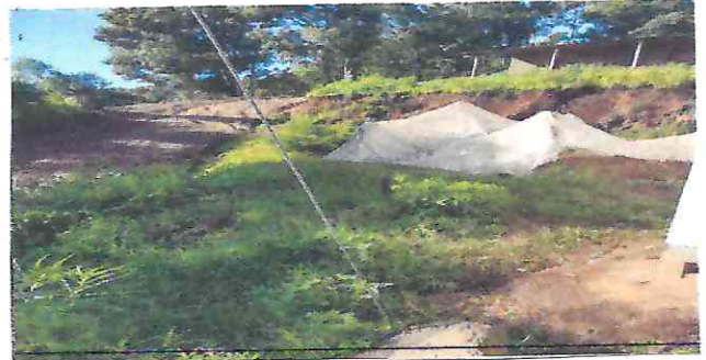
Foto 4: Sanjón al costado derecho de la escuela
